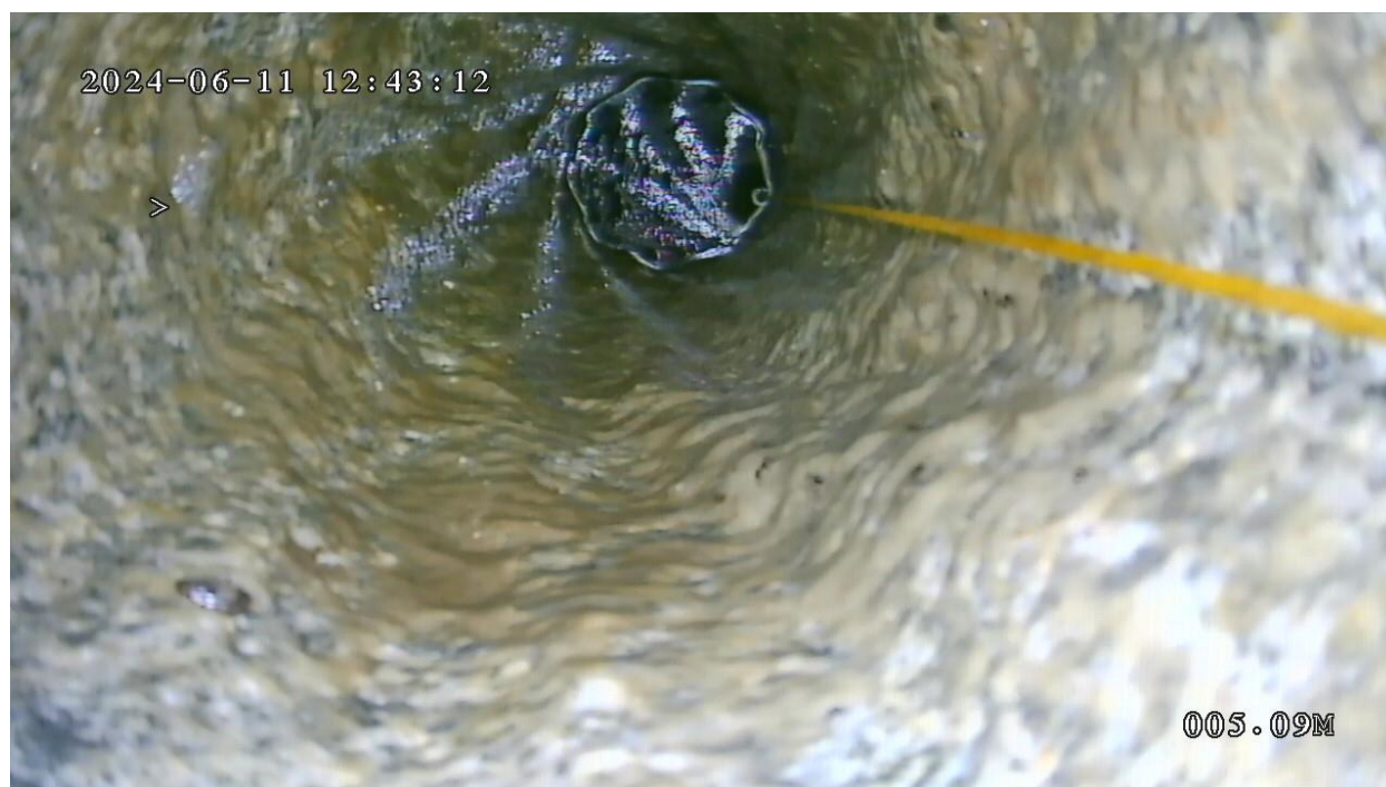
Рисунок 6. Эмульгированные нефтепродукты на стенках скважины 4р Figure 6. Emulsified oil products on the walls of well 4p
